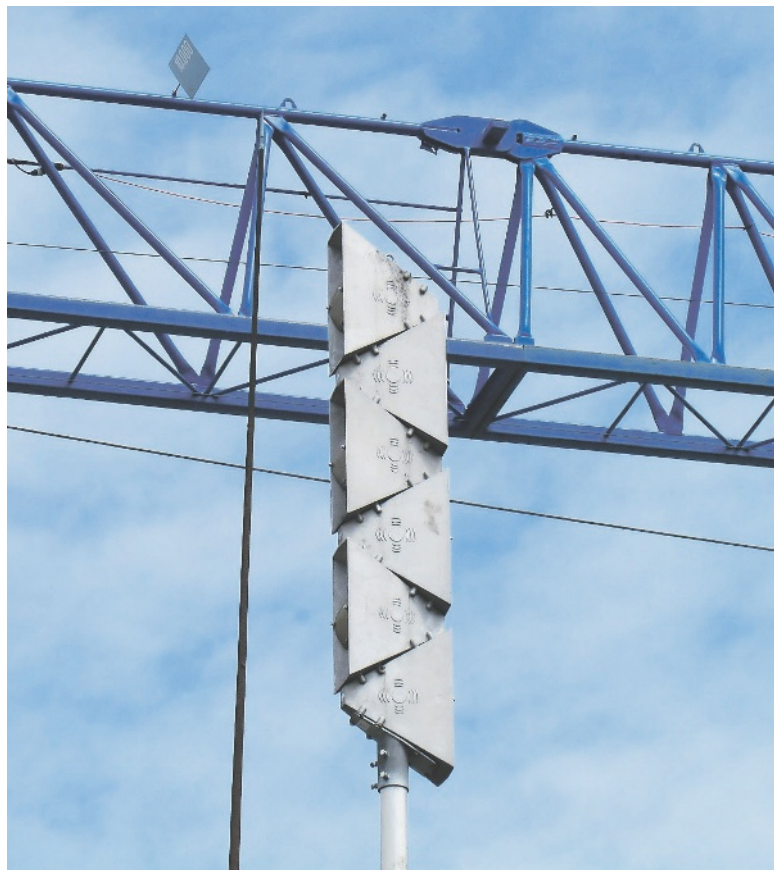
Die Sirenenanlage auf dem Dach der Spitex muss versetzt werden. BILD RENÉ BRECHBÜHL
