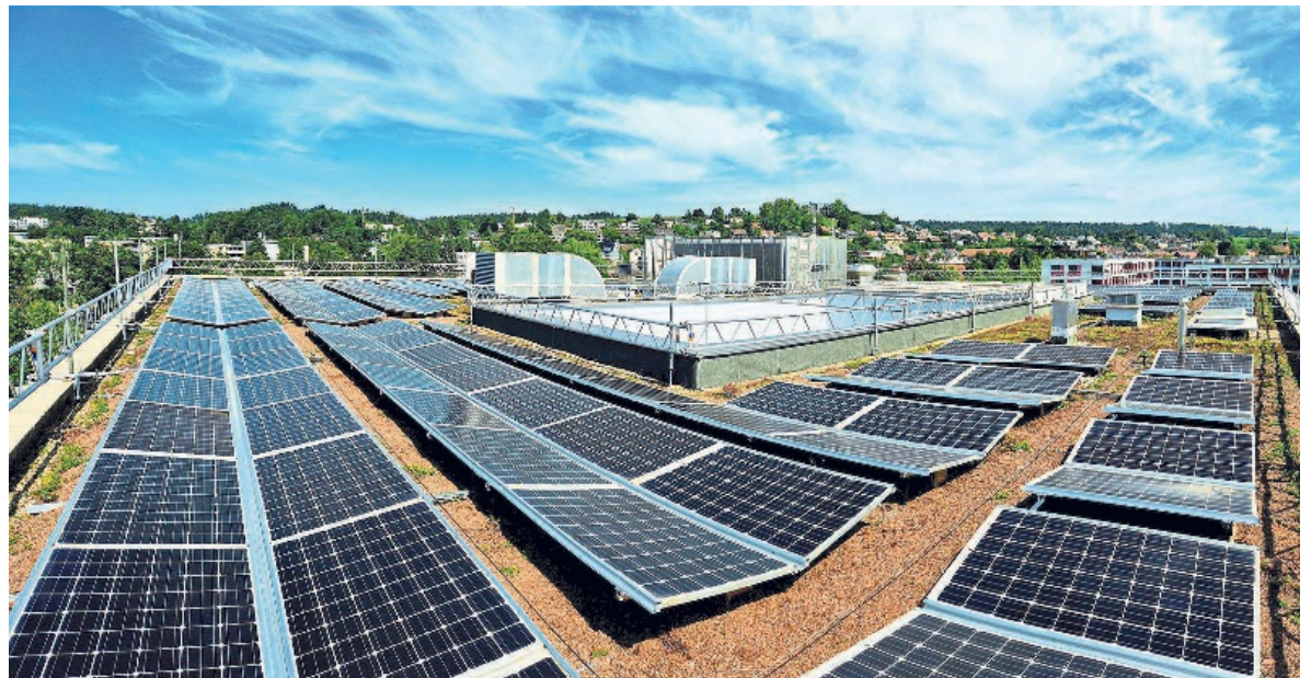
Wiederverwendete Solarmodule auf dem Gemeindehaus. Der Strom wird hauptsächlich im Gemeindehaus genutzt.
