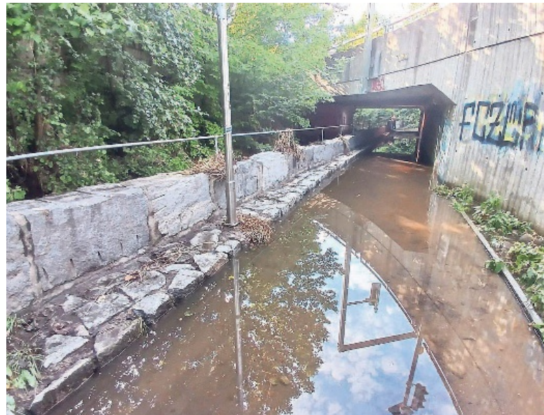
Unterführung an der Industrie-/Stationenstrasse: Die starken Regenfälle von dieser Woche liessen den Chimlibach über die Ufer treten.
