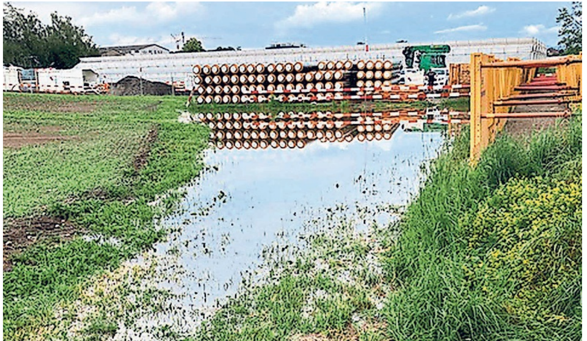
Im Bereich des ehemaligen Bachverlaufs bleibt das Wasser oft tagelang liegen (hier nach einem 45-minütigen Gewitter). BILD B. HIRZEL
